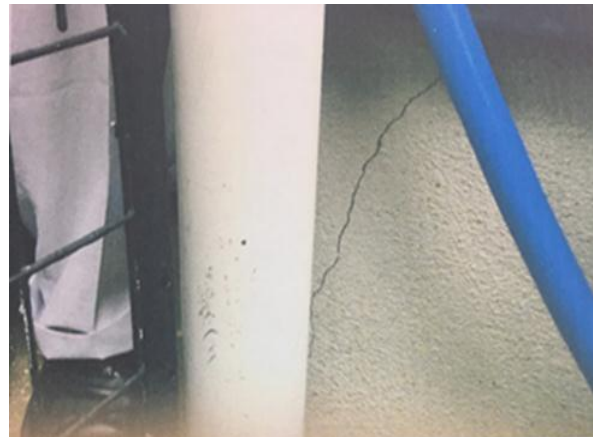
バックアップセンター側で受信している損害画像。家屋の基礎の亀裂が鮮明に確認できる。
